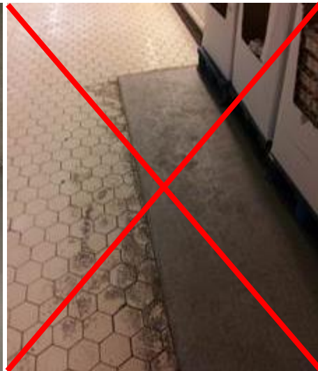
nicht geeigneter Bodenbelag
